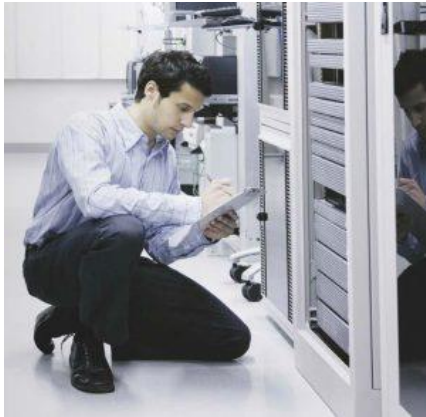
Auditoria y consultoría en Data center
